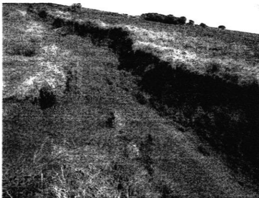
FIGURA 3: EROSIÃO FORMADA APÓS DISSIPADOR DE ENERGIA.
