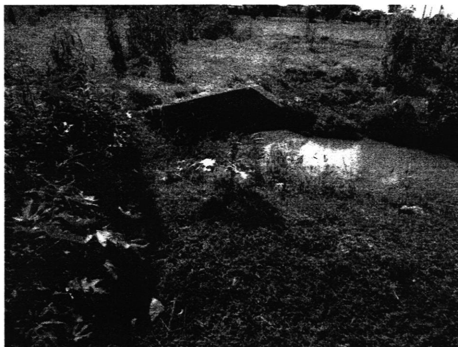
FIGURA 32: DISSIPADOR DE ENERGIA.
